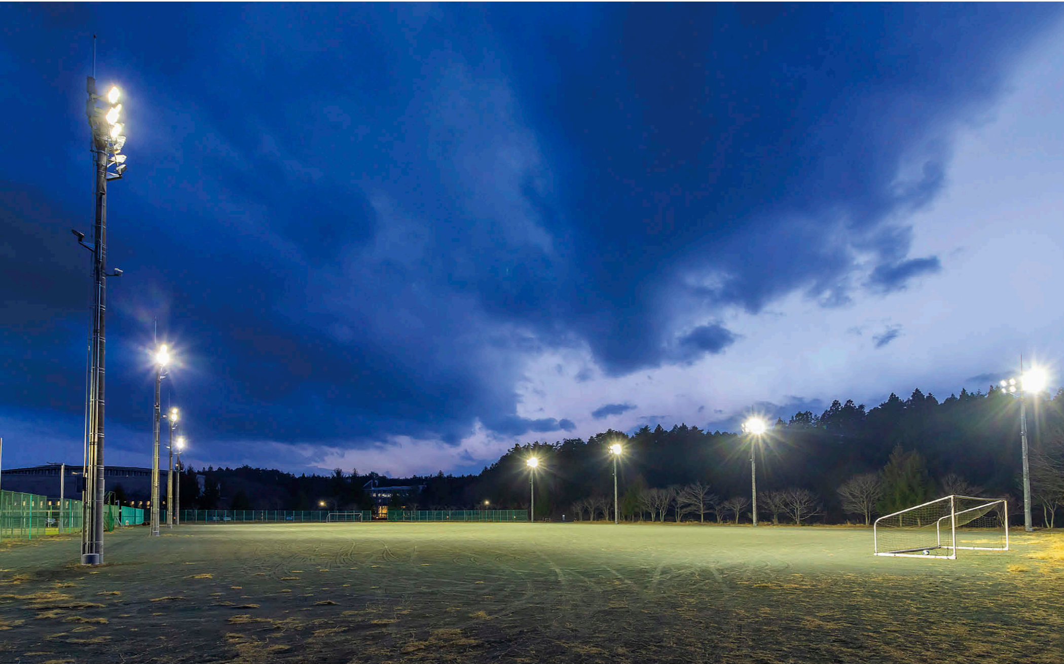
グラウンド 1kWメタルハライドランプ器具相当のLED投光器①64台を既設の高さ15mの照明柱8本に8台ずつ設置。(トラック内平均照度470ルクス)
