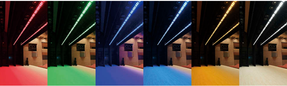
ホールの舞台照明 フルカラーLEDボーダーライト⑦を16台×2列で配置
