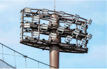
既設照明塔に設置されたLED投光器
