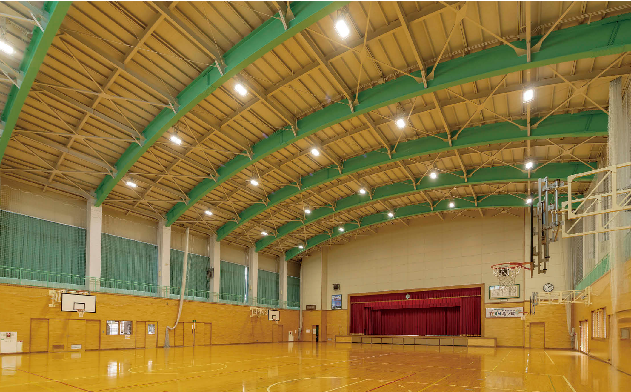
亀ヶ崎小学校(体育館) 20校の小中学校に132台のLED高天井器具まぶしさ低減タイプ①を納入
