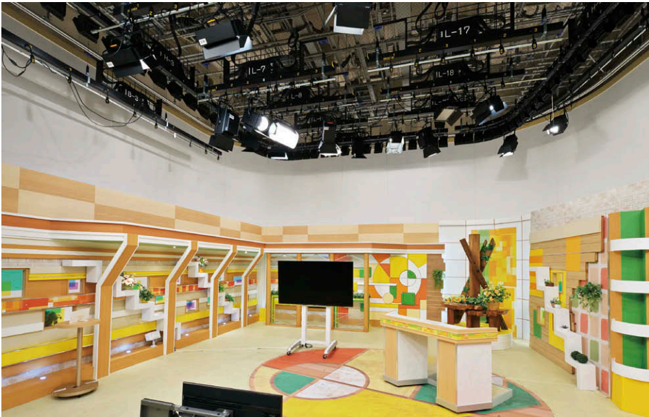
メインセット 各LED照明器具①②③により明るく光に満ちたライティングに
