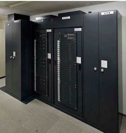
調光器盤 調光ユニットを直ユニットに交換⑩
