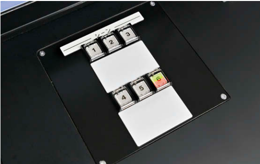
④リモート再生パネル 調光操作卓に新設
