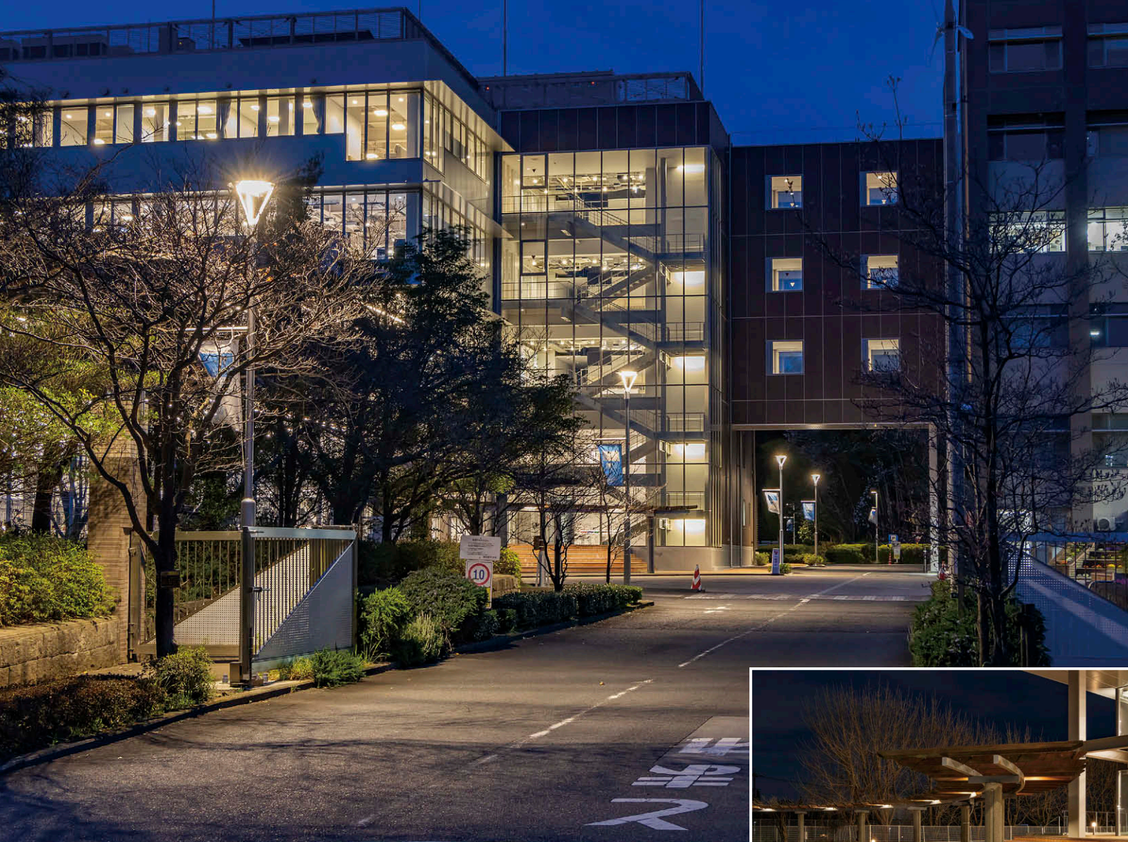
車両門付近から7号館を望む 車両門からバスロータリーを通り駐車場に繋がる車道に沿ってLED街路灯全周配光タイプ①を4台設置して明るいアプローチ環境を実現
