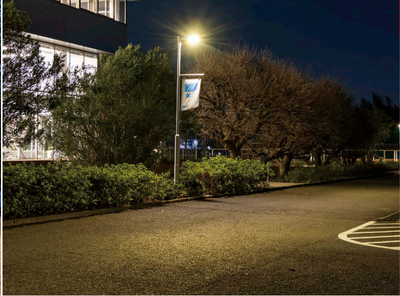
駐車場付近の照明風景 7号館の裏側にあたる車道に設置したLED街路灯横長配光タイプ④
