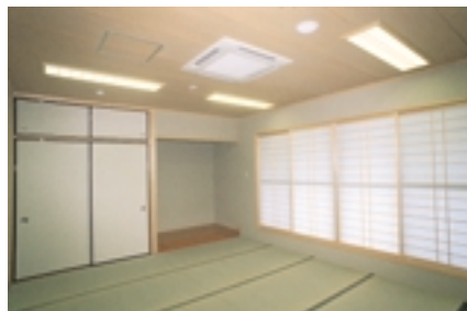
和室には32W電球色蛍光灯2灯用和風埋込器具アクリルカバー付を設置
