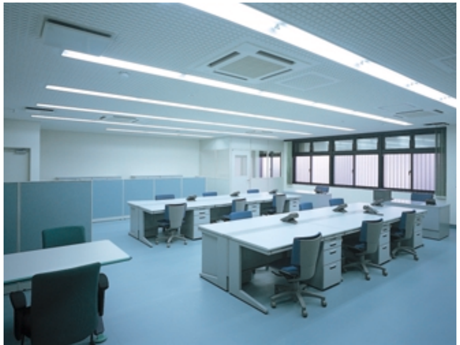
事務室は32W蛍光灯2灯用埋込下面開放器具を連結配置して明るく照明されている
