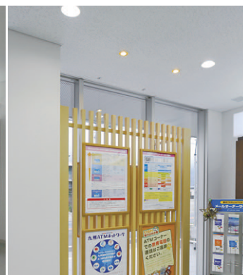
壁面告知用の照明にはIHDダウンライトを設置
