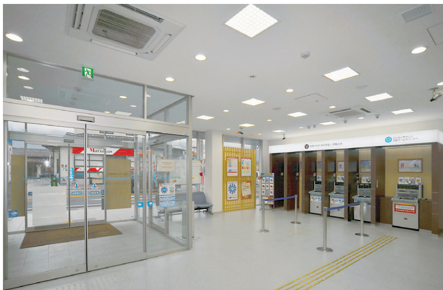
エントランス及びサービスコーナーの照明 〔イー・コア〕LEDベースライトスクエアタイプとLEDダウンライトを併用設置。明るく暖かい雰囲気を創出しながら省エネを実現
