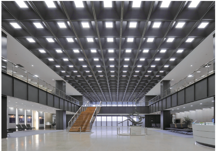
エントランス 床上8mの高さの吹抜天井に採用されたLEDベースライトグレア低減カバー付+あかりセンサで調光制御
