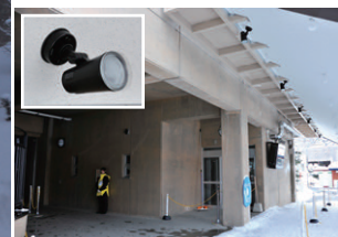
あざらし館の軒下に使用されたLEDスポットライト
