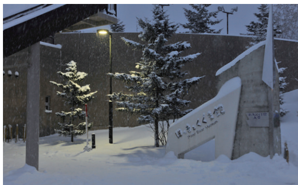
ほっきよくぐま館周辺のLED街路灯
