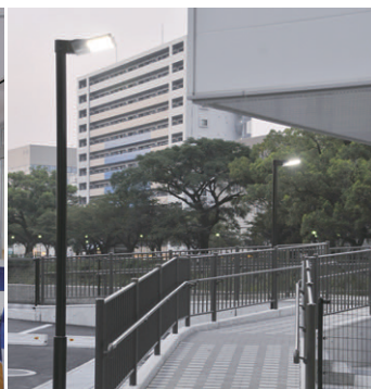
長寿命60,000時間のLED防犯灯を建物周辺に設置
