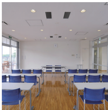
心の安らぎと期待感を与える2階休憩・交流スペースのLED照明
