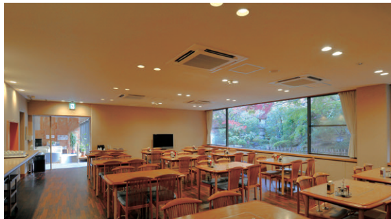
食堂の照明 LEDダウンライトを2台ずつ配置し、テーブル面を重点的に明るくして、ガラスに照明器具が映り込まない快適な視環境と省エネを実現
