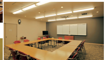
会議室の照明 LEDダウンライトと高効率なHf蛍光ランプ器具との組み合わせ
