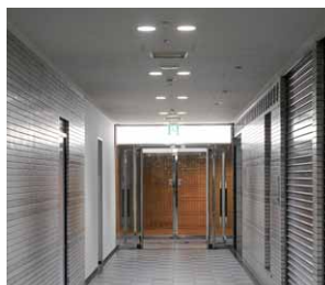
LED一体形ダウンライトによる通路の照明
