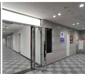
地階廊下・ホールのLED一体形ダウンライトによる照明
