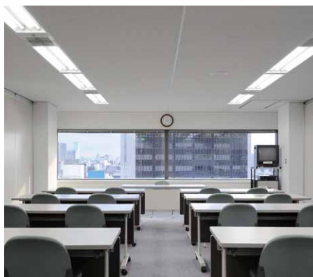
基準階小会議室の直管形LEDランプシステム天井用器具
