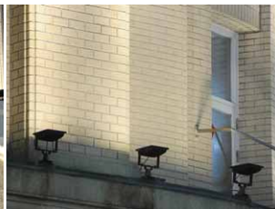
壁面タイルのリフレッシュした表情をくっきりと映し出すLED小形投光器
