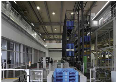
1階物流システム展示体感ゾーンにはLED高天井器具を採用し、消費電力を約48%削減(従来250Wメタルハライドランプ器具)
