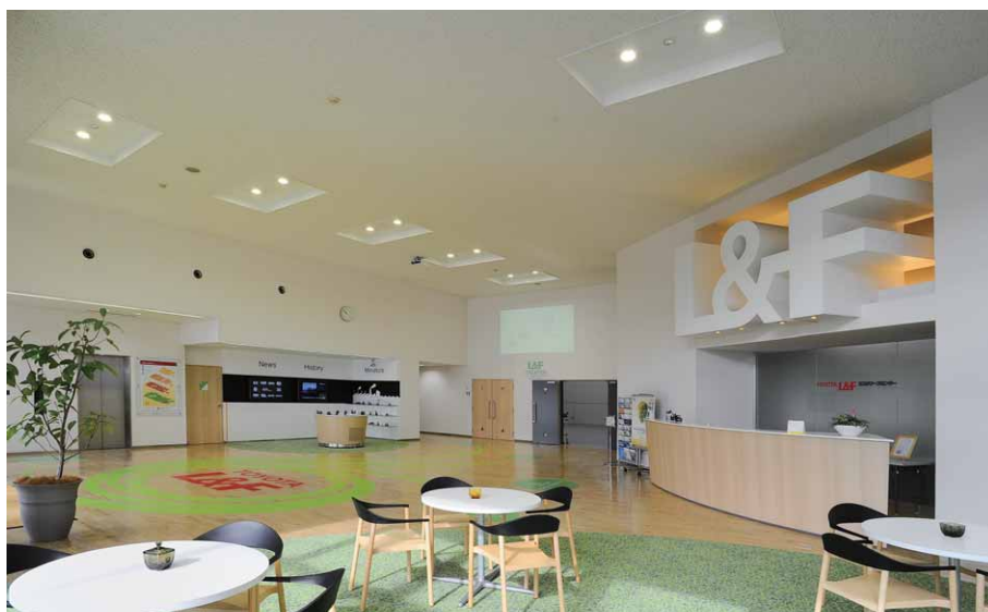
高さ約5mのエントランスホール天井にLEDダウンライト6000シリーズ(昼白色)を掘り上げた天井内に2連配置
