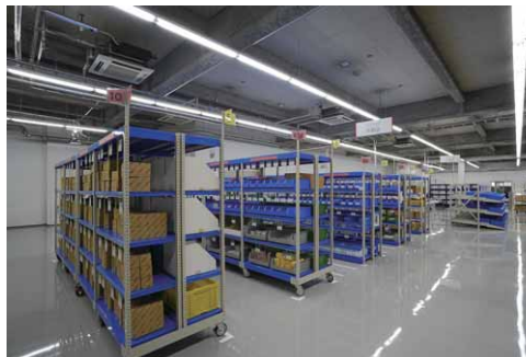
2階の物流システム展示体感ゾーンにはLEDベースライト反射笠器具を連結設置でライン配置
