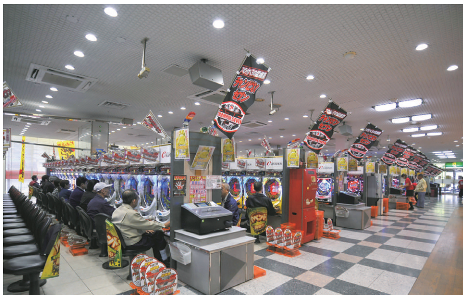
高効率LEDダウンライト「E-CORE100」に更新された店内をメイン通路から全体を望む
