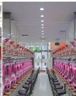
島と島の間の天井に設けられたE-CORE100
