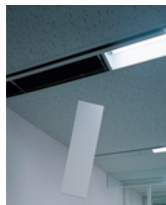
システム天井(オフィスフロア) F-37 System ceiling of the office floor チェーンによる落下防止処理を施した点検用設備プレート。
