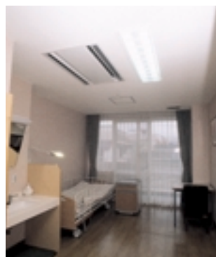
各居室には高齢者の目にまぶしくないようグレア防止のルーバー付40W蛍光灯ランプ2灯用ホスピタルソフト埋込形器具(病院・福祉施設照明器具)が配置されている
