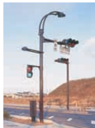
信号共架道路灯 (長野県佐久建設事務所発注分) A street light sharing the pole with signal lights
