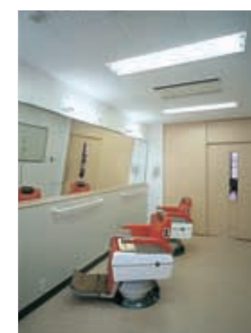
理容室 Barber's 32W2灯用Hf-Lcc(ロコ)シリーズ埋込器具下面開放を設置
