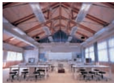
コンピュータ室 Computer room 40W 蛍光ランプ2灯用器具パラボリックルーバで学習用途に合わせた高品質な照明を設けている。
