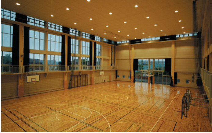
アリーナ：広々とした高天井空間となっているアリーナは、メンテナンスに配慮してオートリレー付HID埋込ダウンライトを採用。400Wメタルハライドランプを光源に、下面ガード付と光補償装置付下面強化ガラスのものを採用し安全性を高めている
